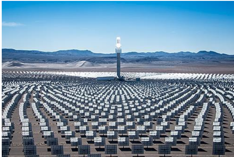
圖 1. 太陽能發電塔（台達新聞中心，2015）。
