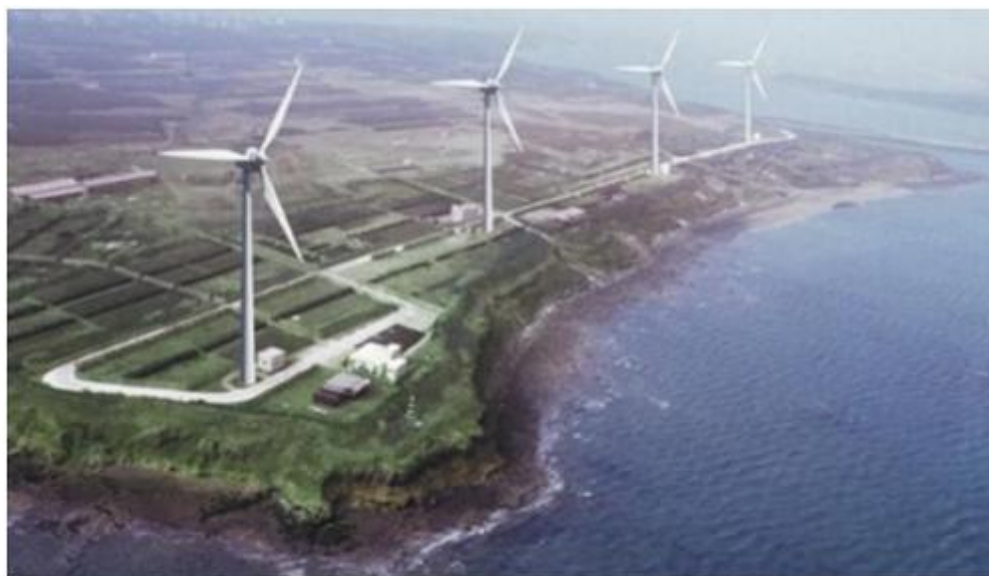
國內第一座設置於離島的風力發電場：澎湖中屯風力發電示範系統。
