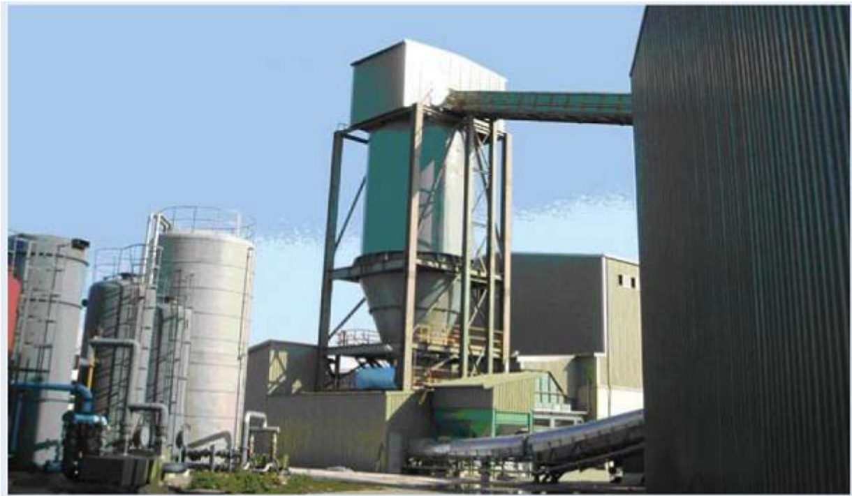
工廠生產RDF-5後輸送至儲存槽，再透過輸送系統送至汽電共生鍋爐使用。圖片上方輸送帶是把製造廠製造的RDF-5運送至儲槽。下方則由儲槽透過輸送帶，把RDF-5直接運送至氣泡式流體化床汽電共生鍋爐做為燃料使用。
